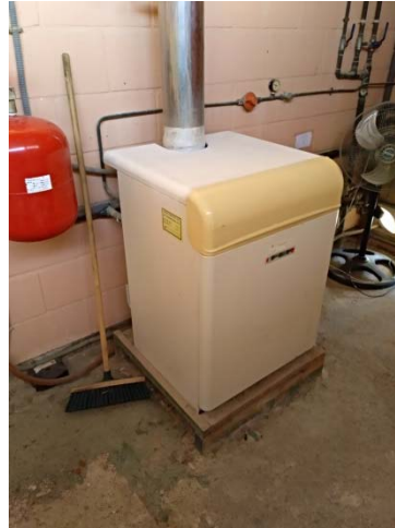
Imagen 19. Caldera de ACS
