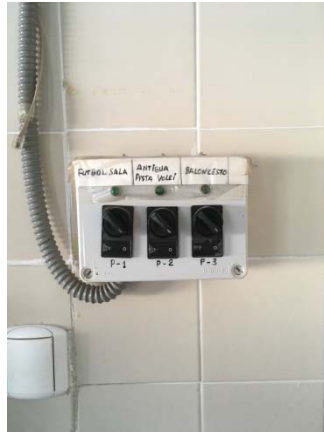
Imagen 4. Interruptores de encendido alumbrado exterior
