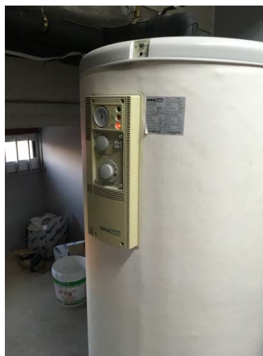
Imagen 10. Acumulador solar térmico
