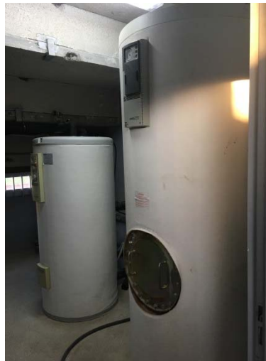
Imagen 11. Acumuladores de ACS del estadio municipal
