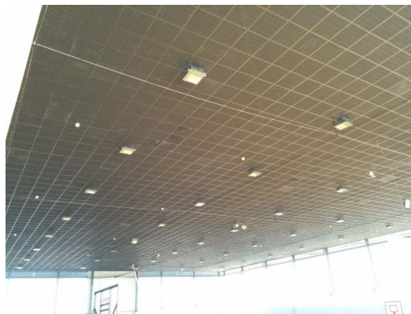
Imagen 70. Alumbrado interior pabellón Gran Alacant
